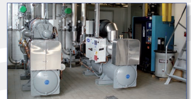
Eine der Kältezentralen
